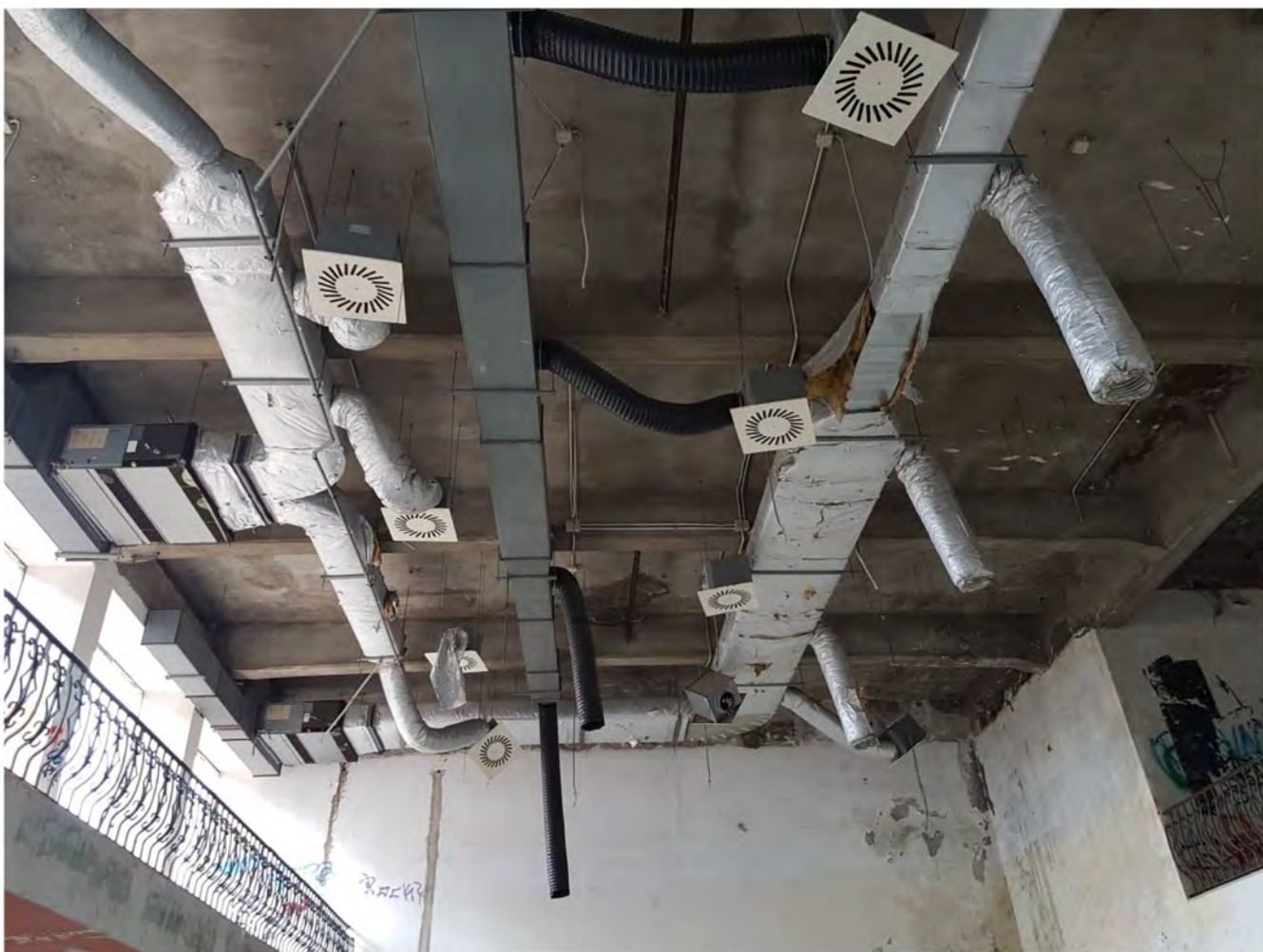
Foto15 Il Salone Gli impianti di climatizzazione
